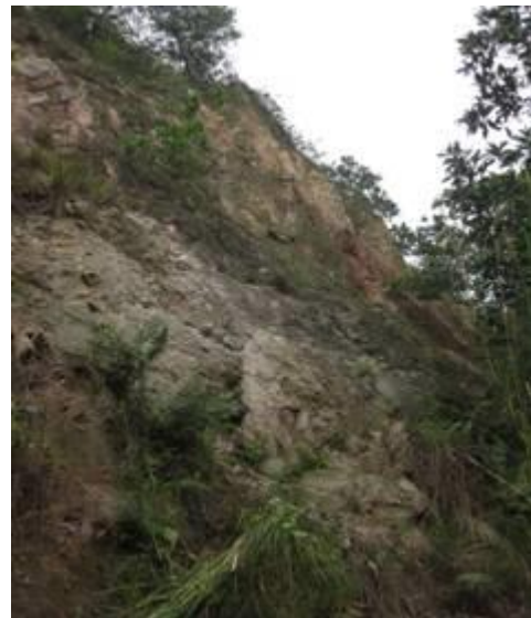
Ảnh 2. Khu vực có nguy cơ trượt lở nằm ngay cạnh một số nhà dân phía bắc nhà máy Nhiệt điện Phả Lại.
