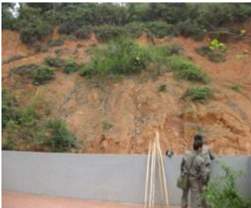
Ảnh 1. Điểm trượt lở đã xảy ra nằm ngay cạnh nhà dân và có nguy cơ trượt lở tiếp gây nguy hiểm tại khu vực Vườn Đào, xã Hưng Đạo.
