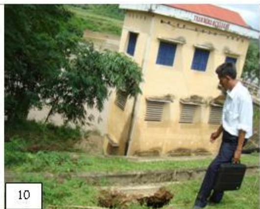
Hình 10. Khai thác vàng sa khoáng gây sạt lở bờ sông, làm cho trạm bơm Châu Khê bị sụt lún (chụp ngày 01/8/2009 tại xã Châu Khê, huyện Tương Dương).
