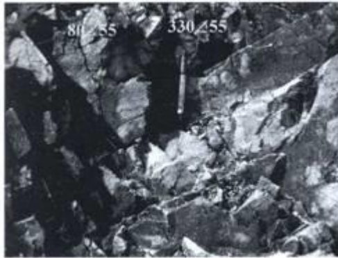
Ảnh 2a. Đới dập vỡ tại taluy dốc đứng (Ảnh: Chu Văn Ngợi, 2014).
