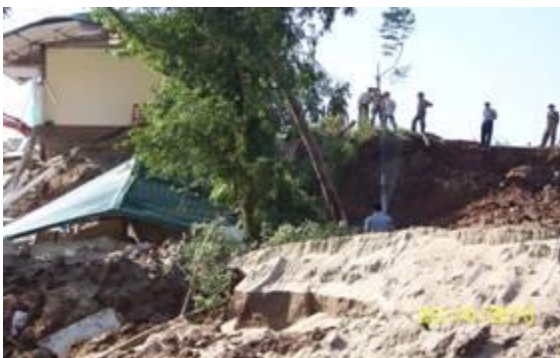
Hình 4. Xói lở bờ sông Hồng (phía hữu ngạn) gây sạt đất, phá hoại cây cối, nhà xưởng và đe dọa khu dân cư tại cảng Sơn Tây, phường Phú Thịnh (TX. Sơn Tây, 10/2010). Ảnh Trần Ngọc Khôi, 2010.
