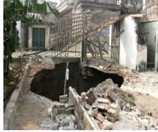
Hình 7. Vụ sụt lún đất xảy ra cuối năm 2010 làm đổ tường bếp và sụt sấn nhà dân tại xóm 16, thôn Áng Hạ, xã Lê Thanh (h. Mỹ Đức). Ảnh VietnamNet, 2010.
