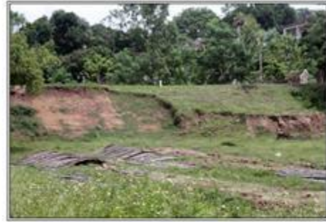
Hình 17. Khe nứt á kinh tuyến chạy dọc theo đê, làm sạt mái đê tại xã Phong Vân.
