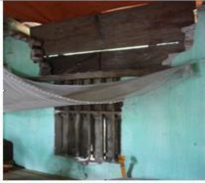
Hình 16. Nhà anh Tùng bị sập và nứt vỡ từ móng nhà tới nóc nhà.
