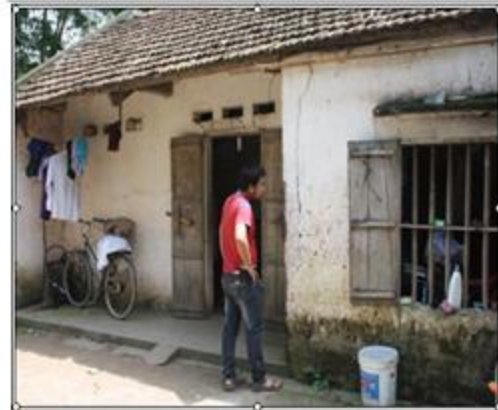
Hình 15. Khe nứt á kinh tuyến cắt ngang tường nhà dân từ trước ra sau nhà tại xã Phong Vân, Ba Vì.
