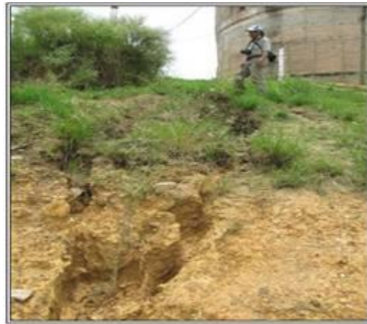
Hình 21. Đất nứt dài hàng chục mét dọc khe nứt á kinh tuyến cắt ngang bờ sông Lô tại xã Minh Đạo (Việt Trì) năm 2011.
