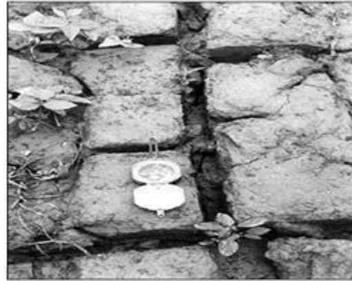
Hình 19. Khe nứt thẳng kéo dài 10 m phương á kinh tuyến tại Tân Đức năm 1996.
