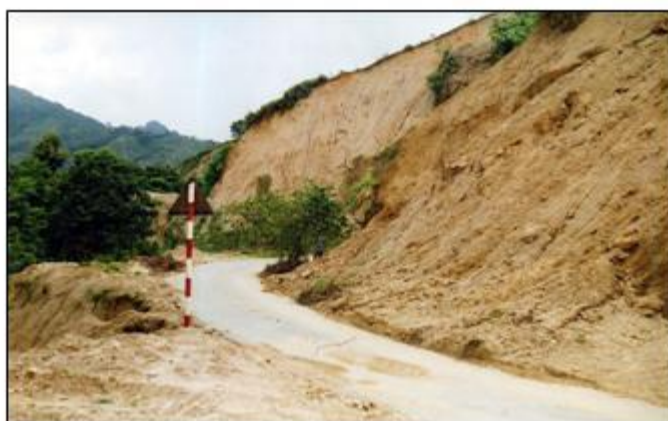
Hình 2. Trượt vách taluy dương và âm trong lớp vỏ phong hóa vụn thô trên đèo Tản Sà Phìn.
