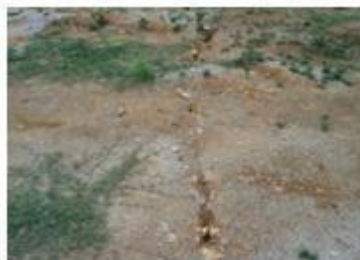
Vết nứt quan sát được tại vùng C10.
